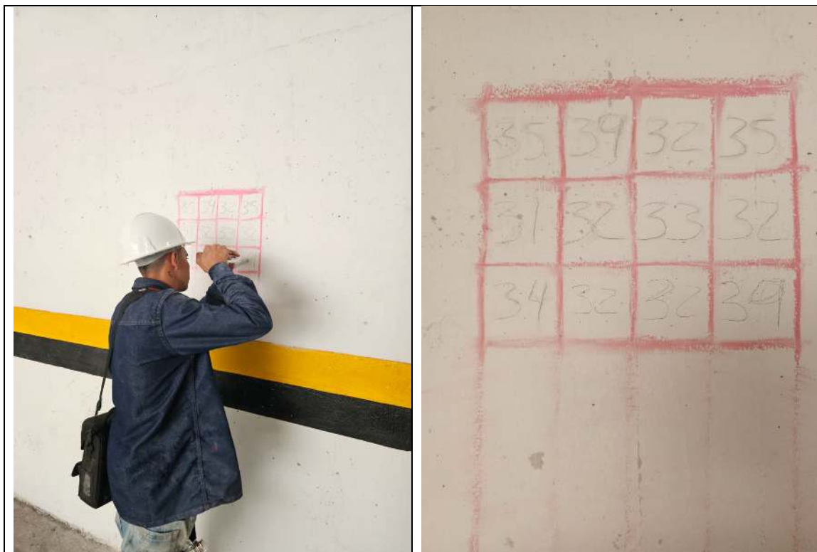
Ilustración 20 Realización del ensayo de índice esclerómetro en muro 2
