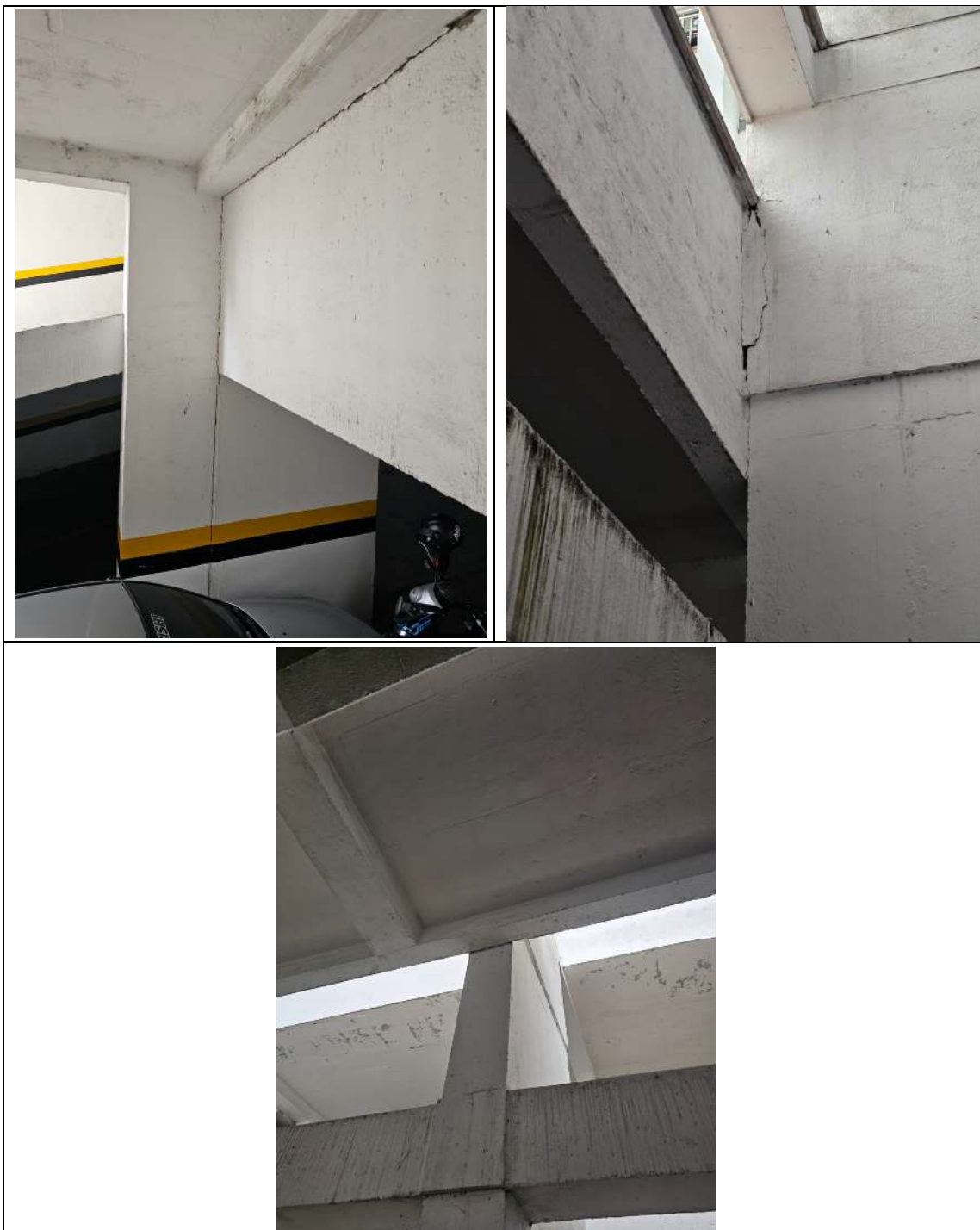
Ilustración 12 Ausencia de junta sísmica 2
