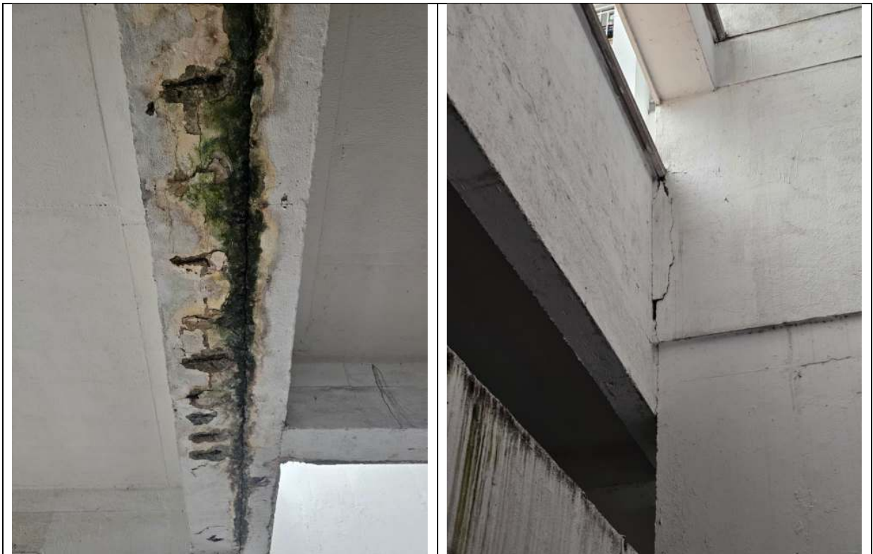
Ilustración 11 Ausencia de junta sísmica.
