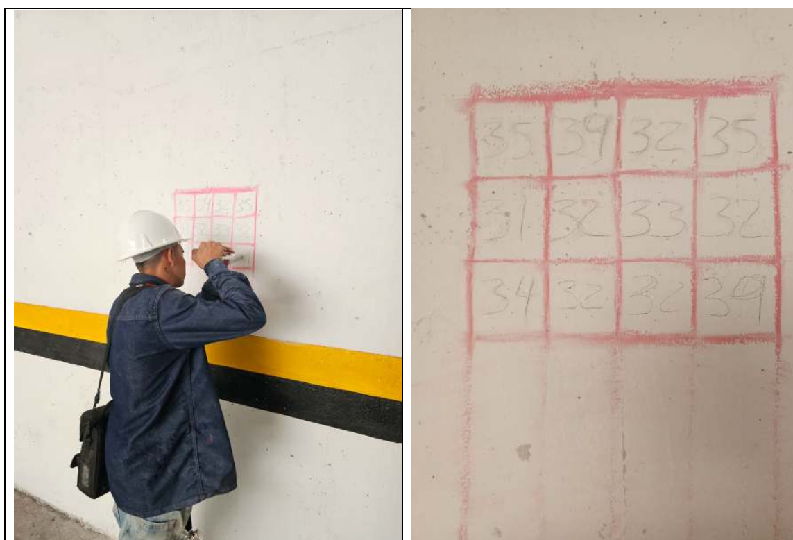
Ilustración 19 Realización del ensayo de índice esclerómetro en muro 1
