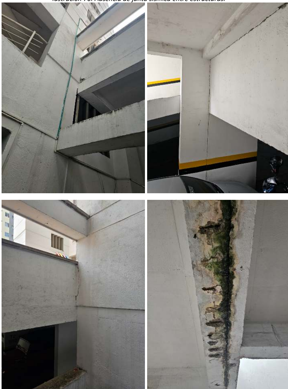
Ilustración 76: Ausencia de junta sísmica entre estructuras.
